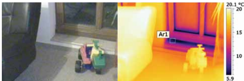
Questo test Blower Door mostra chiaramente la presenza di perdite d'aria dall'intelaiatura della finestra.
