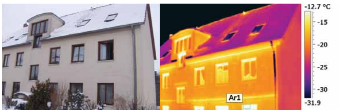
In questo esempio il lucernario più a destra presenta una perdita di calore e vi sono diversi punti in cui l'isolamento del tetto è inefficace.
