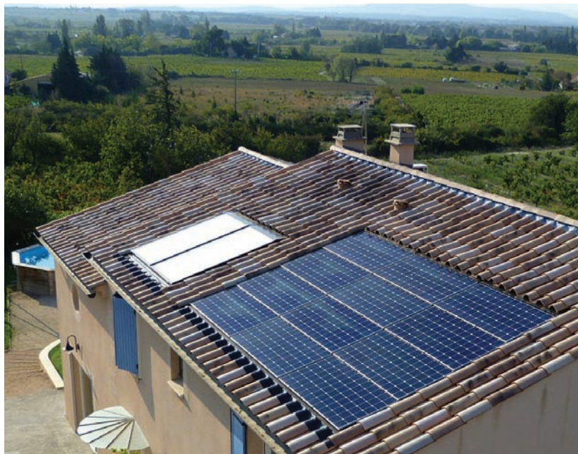
12 Moduli SPR-245NE, 2,94 kW, Drôme – Francia
